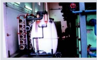
Planta desaladora de ósmosis inversa
